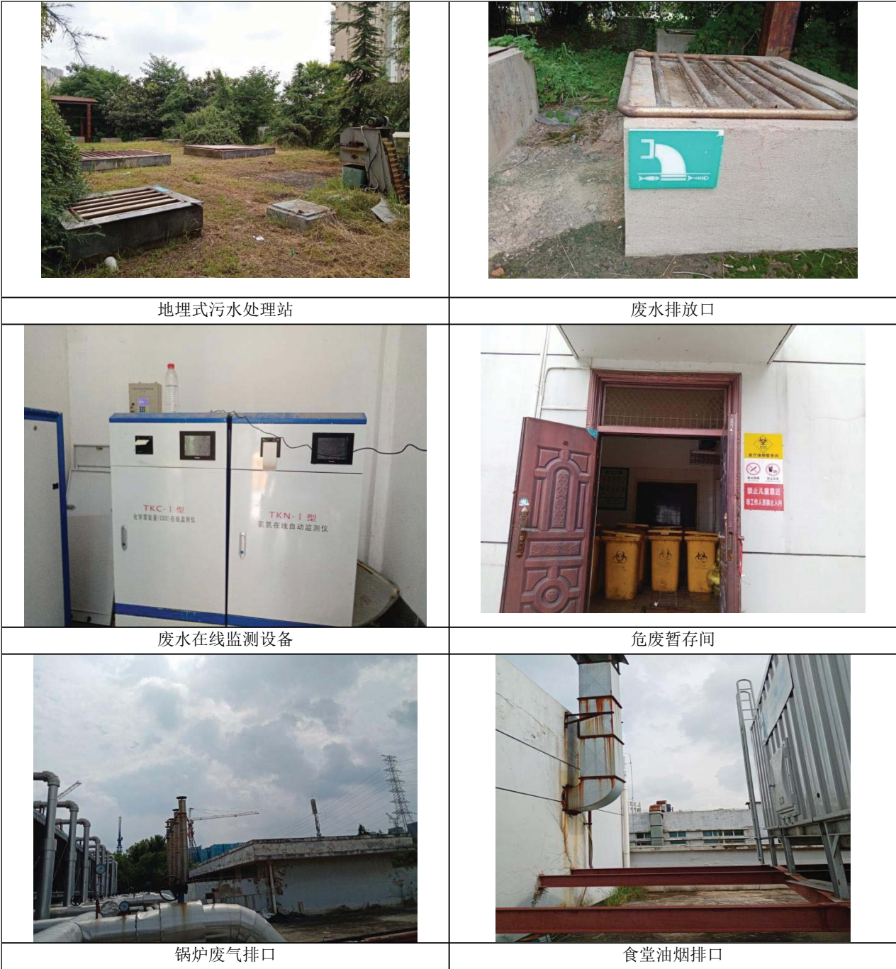
图 2.1-3 现有工程环保设施现状图
